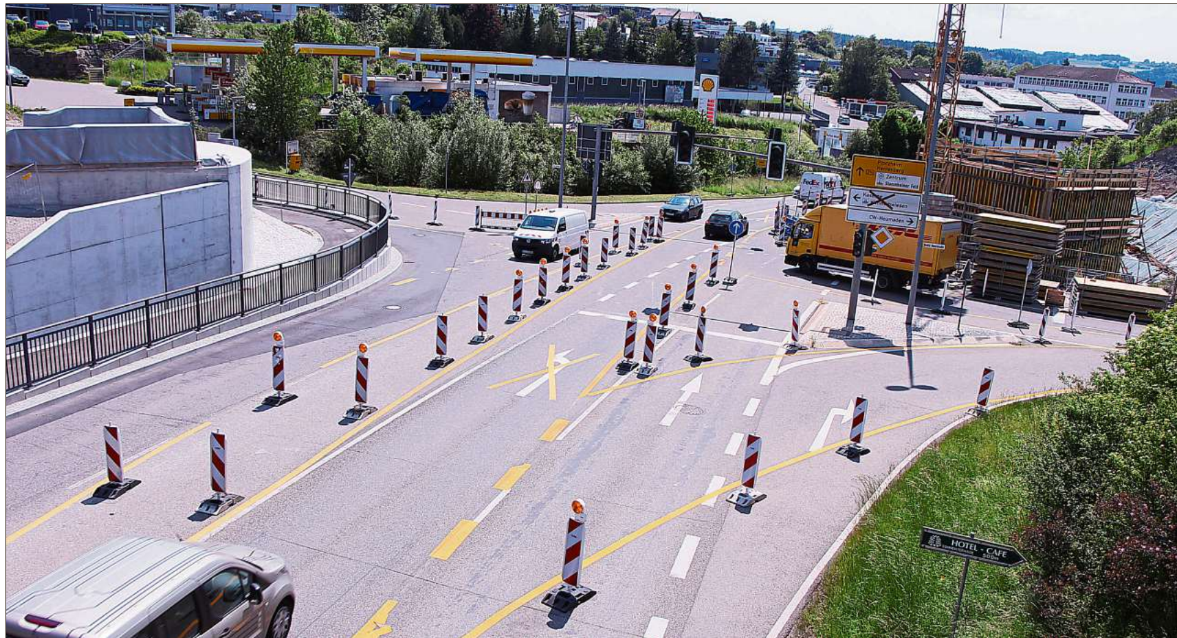
Im Sommer vergangenen Jahres wurde mit den Bauarbeiten für die beiden Widerlager begonnen, nun sind diese wohl bald beendet.
