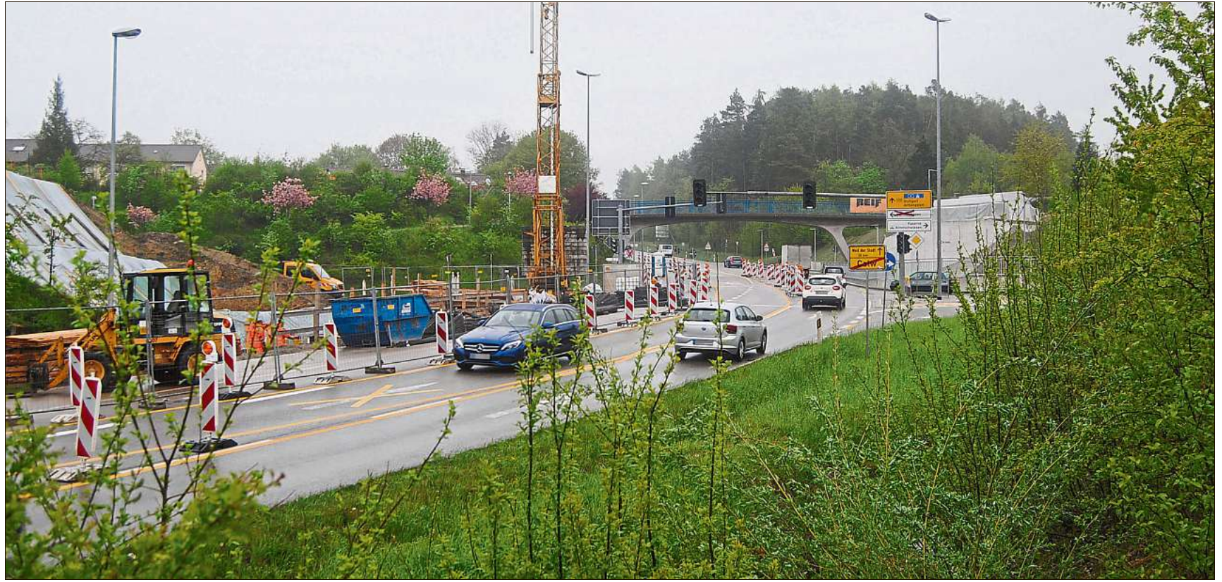
Die Fußgängerweg bei Heumaden ist ab 2. Mai wieder offen.
